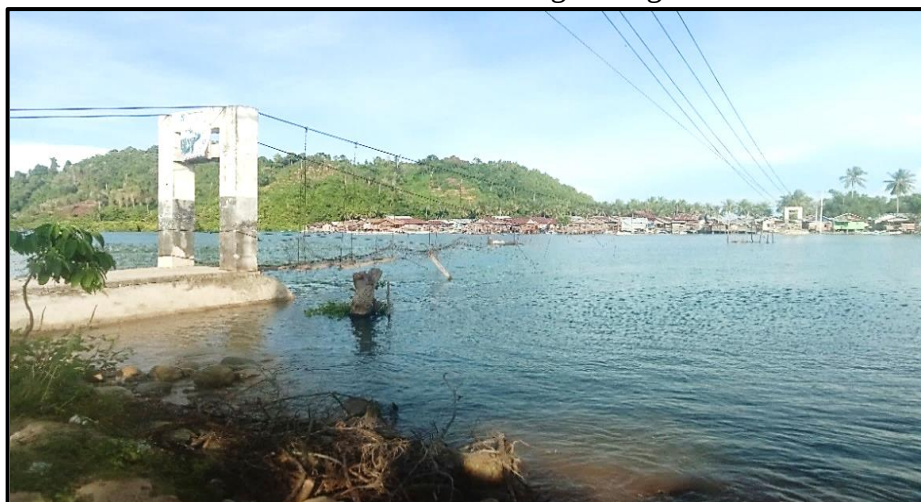
Gambar 1. Kerusakan Jembatan Penghubung di Dusun Salu
