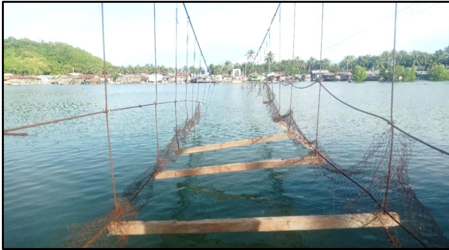
Gambar 2 Kerusakan Jembatan Penghubung di Dusun Salu
