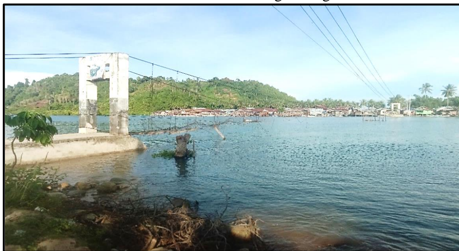
Gambar 1. Kerusakan Jembatan Penghubung di Dusun Salu
