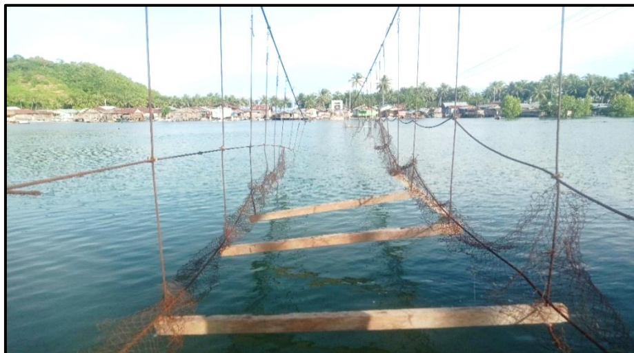
Gambar 2 Kerusakan Jembatan Penghubung di Dusun Salu
